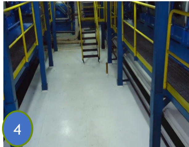
18V46 Wartsila Diesel power barge plant operate by EEN personnel
